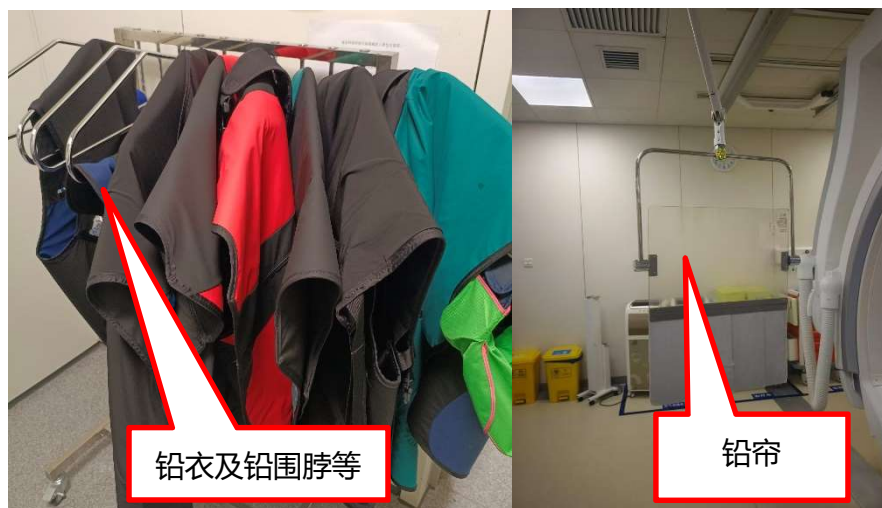
图 3-7 手术室部分防护用品及铅帘现场图
