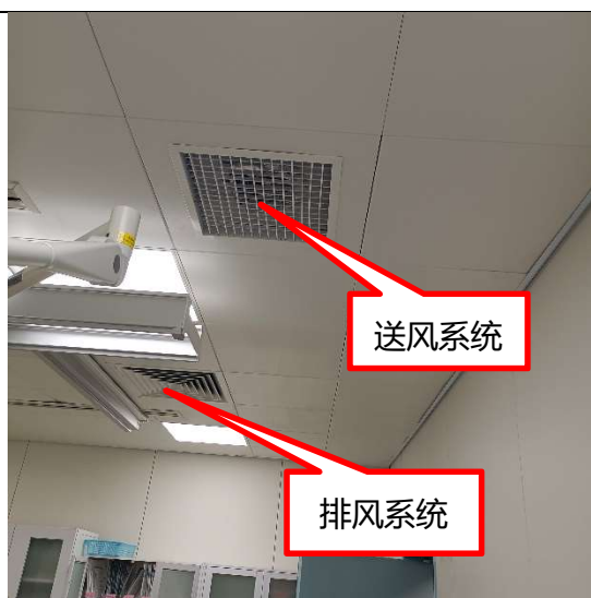
图 3-8 手术室排风及新风系统现场图
