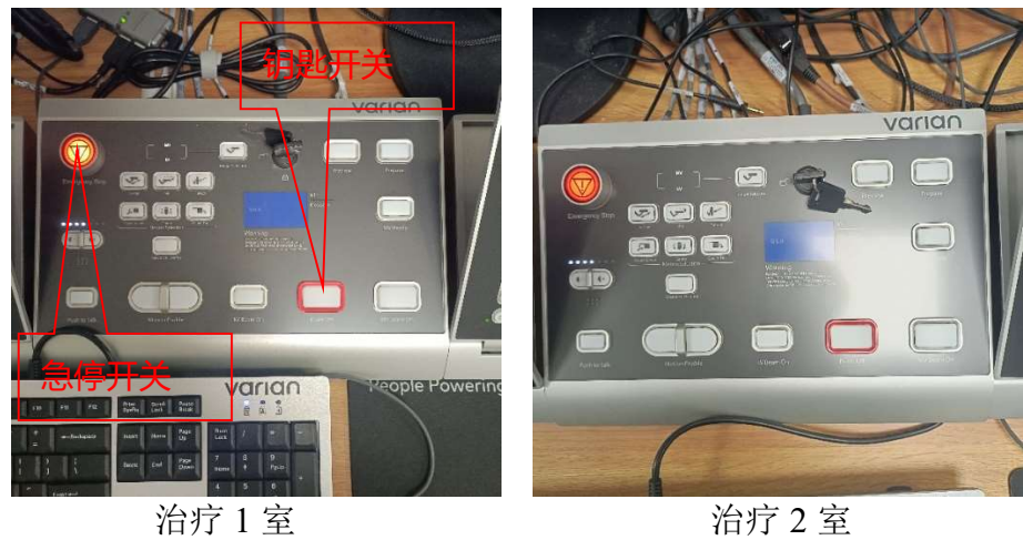
图 3-2 治疗室直线加速器控制台
